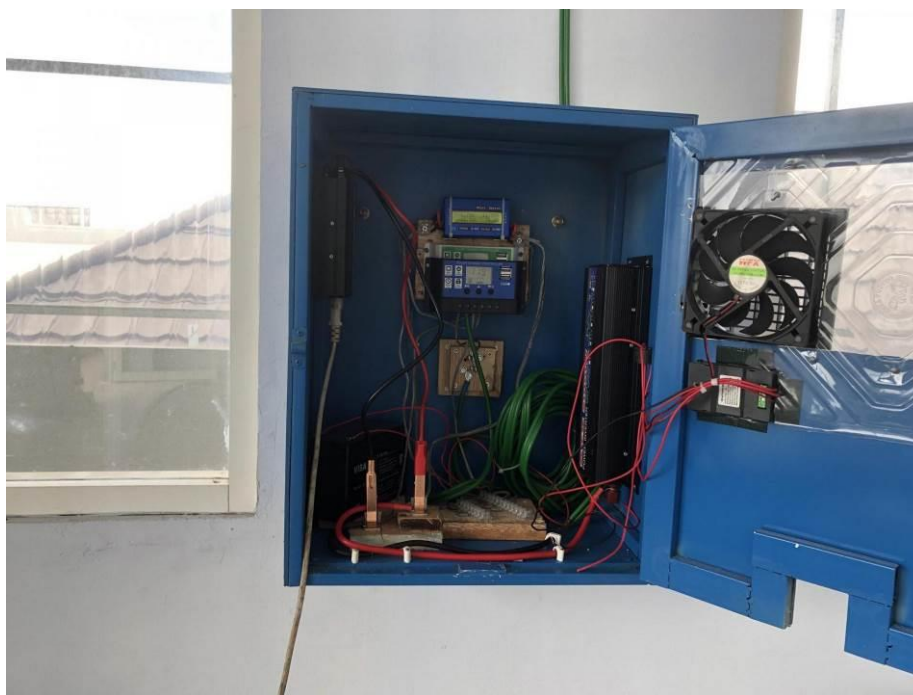
Gambar 6. Sistem kendali, inverter, dan baterai
